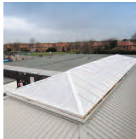
Oberlichter, Dachfenster und Rauchabsaugeinrichtungen
